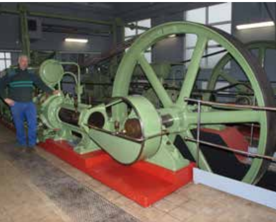
De compressoren uit 1922 worden nog zelden gebruikt, maar worden dermate goed onderhouden dat ze elk moment weer opgestart kunnen worden.
