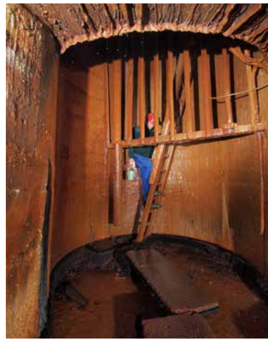
De noodtrap in de Puits du Croisier is dik aangeslagen met calciet.
