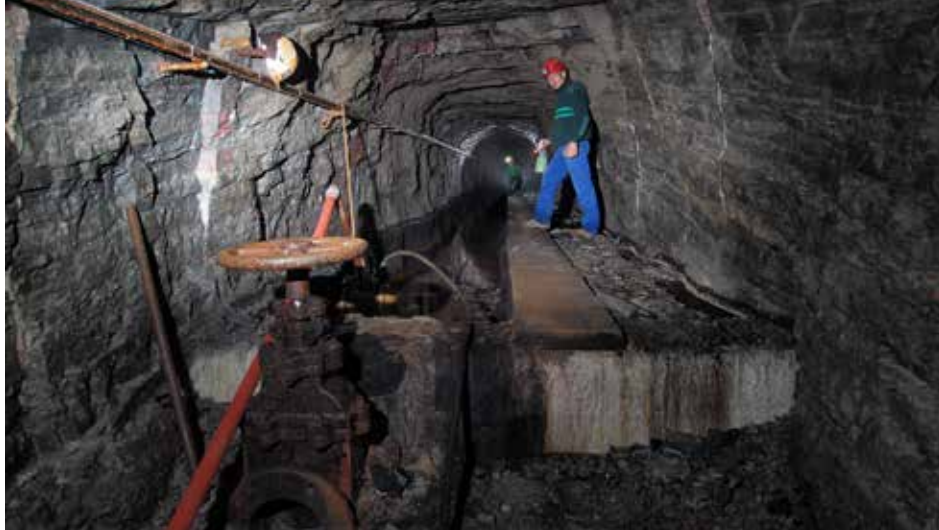
David Duvivier toont ons de werkplaats. Een opvangbekken dat aangetast is door betonrot moet worden hersteld.
